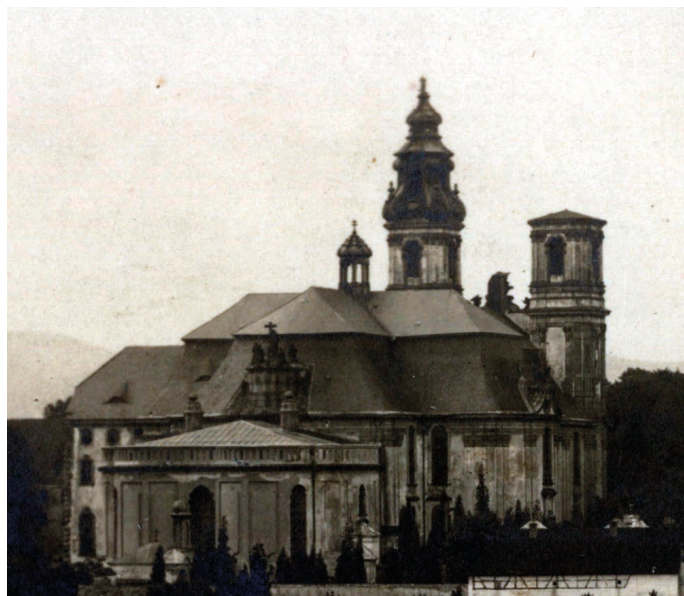
9. Tymczasowe nakrycie północnej wieży krzeszowskiego kościoła. Twórcy tego rozwiązania w pierwszej kolejności patrzyli na to, aby możliwie szybko i w miarę niskim kosztem zabezpieczyć budynek przed zniszczeniem, a walory estetyczne odgrywały tu drugorzędą rolę.
