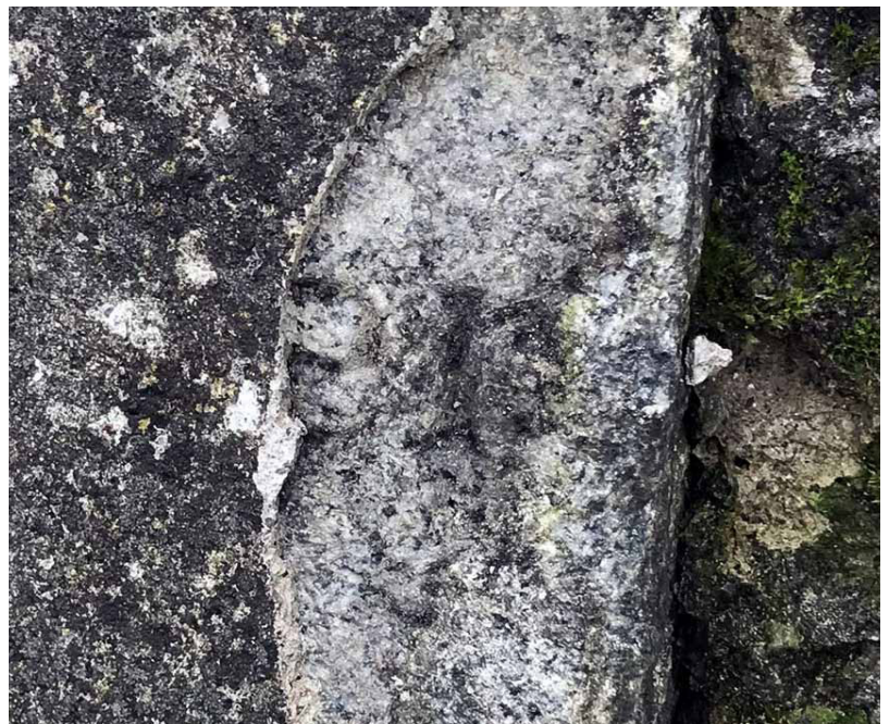
Litery „...er” wyłaniające się spod odpadającej warstwy betonu
