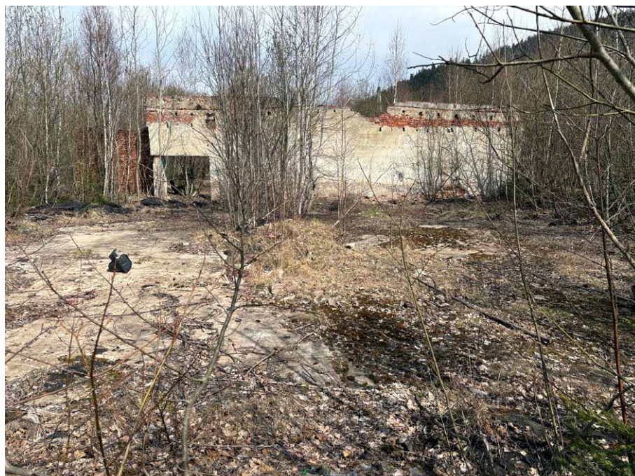
Dziś po dawnej hali nr 4 pozostała tylko posadzka i jedna ze ścian. Zdjęcie: Marian Gabrowski.
